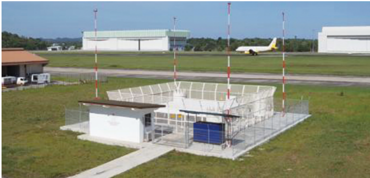
中国电科自主设计制造文莱斯里巴加湾国际机场跑道旁的 GLC-24A 型对流层风廓线雷达，为起降的航班安全保驾护航。
